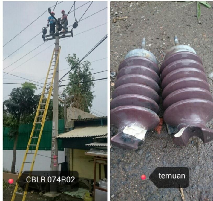
Gambar 3.4 Gangguan Akibat Isolator Pecah
