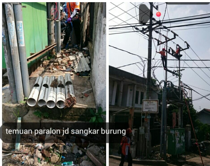
Gambar 6. Gangguan akibat sarang burung
