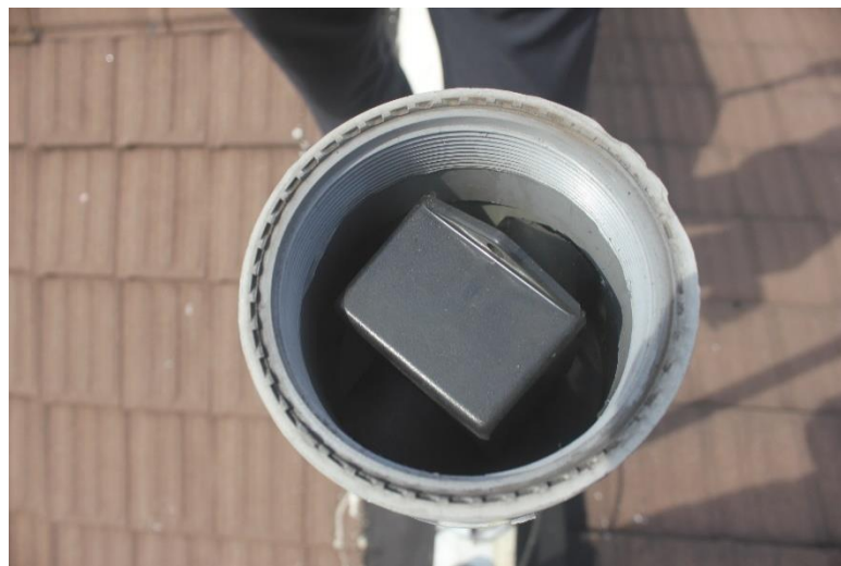
Gambar 30. Kondisi antenna di dalam pipa PVC
